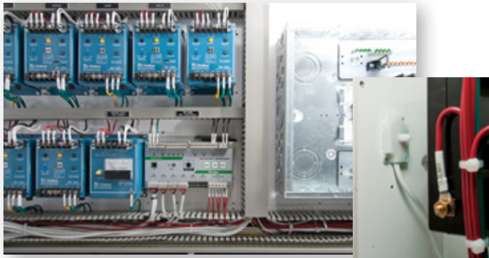
Figura 2. Instalação típica do relé de arco elétrico, PGR-8800 e o sensor de luz
