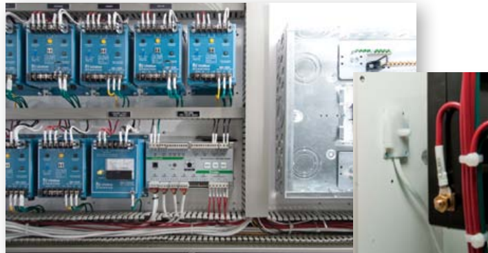
Figura 2. Instalación típica del Relé contra arco PGR-8800 y el sensor de luz.
